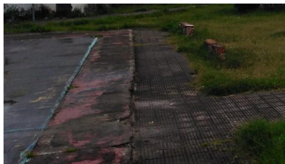
Imagem 09 – Foto tirada in loco dos desníveis da circulação entre as quadras. Fonte: COPROJ-SEINF.
