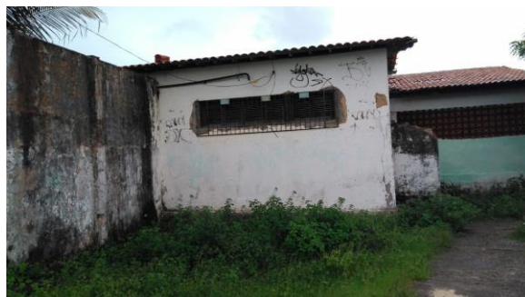
Imagem 17 – Foto tirada in loco na circulação de acesso a CEI Virgílio Távora. Fonte: COPROJ-SEINF.
