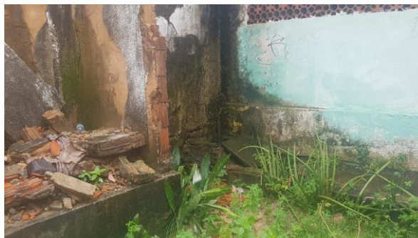
Imagem 19 – Foto tirada in loco onde se encontra o sumidouro artesanal. Fonte: COPROJ-SEINF.
