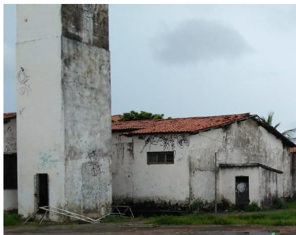
Imagem 21 – Foto tirada in loco mostrando acesso da caixa d'água e cisterna. Fonte: COPROJ-SEINF.
