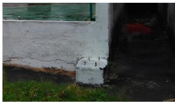
Imagem 05 – Foto tirada in loco estrutura em concreto com armadura descoberta. Fonte: COPROJ-SEINF.
