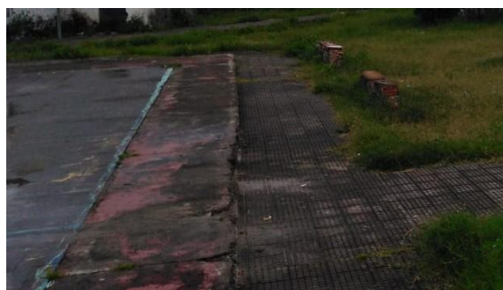
Imagem 13 – Foto tirada in loco dos desníveis da circulação. Fonte: COPROJ-SEINF.
