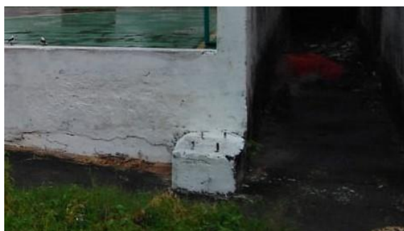
Imagem 12 – Foto tirada in loco de estrutura da quadra maior em concreto com armadura descoberta. Fonte: COPROJ-SEINF.
